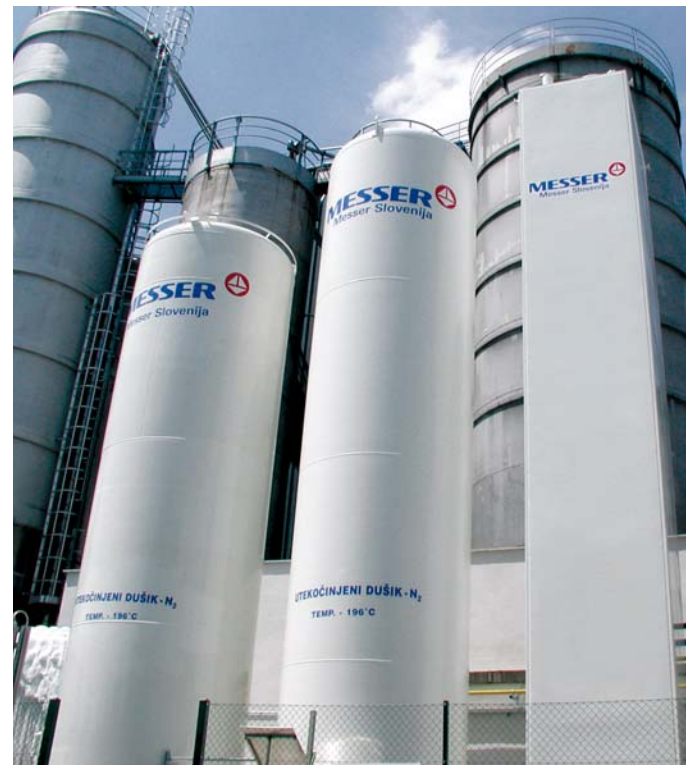
Bei Julon wurde der kleinste Luftzerleger der Messer Gruppe installiert.
