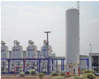
Eine neue Wasserstoffanlage in Zhangjiagang.
