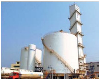
Auch eine Luftzerlegungsanlage ging in Zhangjiagang in Betrieb.
