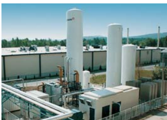
Bei Zoltek wurde ein zweiter Stickstoffgenerator in Betrieb genommen.
