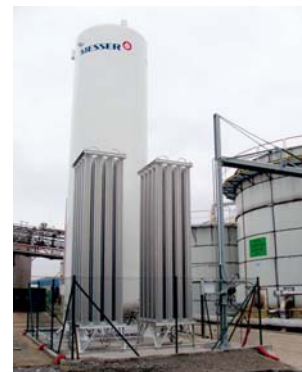
Kläranlage Spolchemie in Usti nad Labem.
